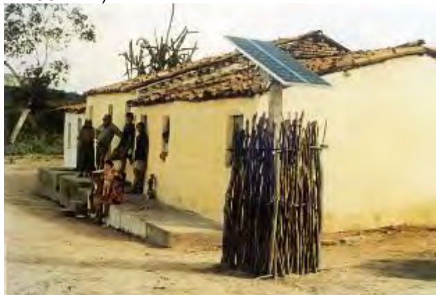
FOTO 7 – ENERGIA FOTOVOLTAICA / SOLAR (ESCOLA ISOLADA)
